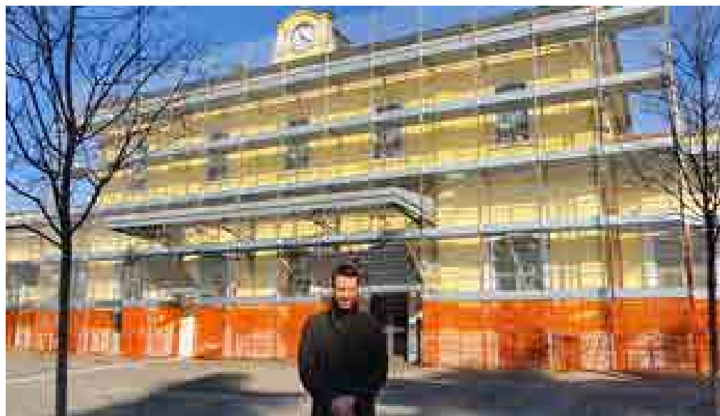
L'assessore Fabio Bergamaschi davanti alla stazione ferroviaria, dove sono partiti i lavori
